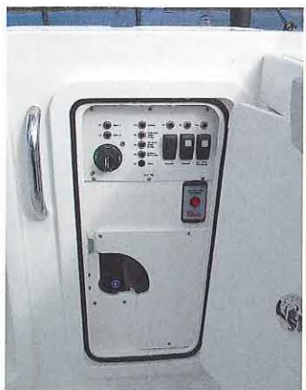
Perfekt zugänglich: E-Panel in der achterlichen Cockpitwand
